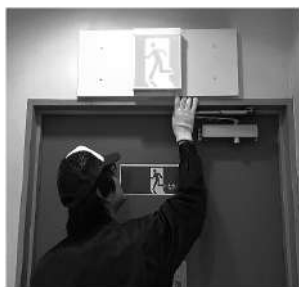
誘導灯バッテリーチェック
