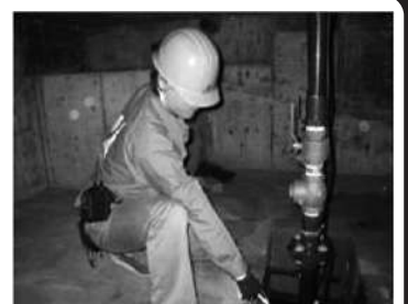
排水ポンプ点検
